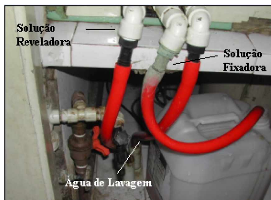
Figura 4.7. Canos de despejo das soluções químicas utilizadas no hospital B.
