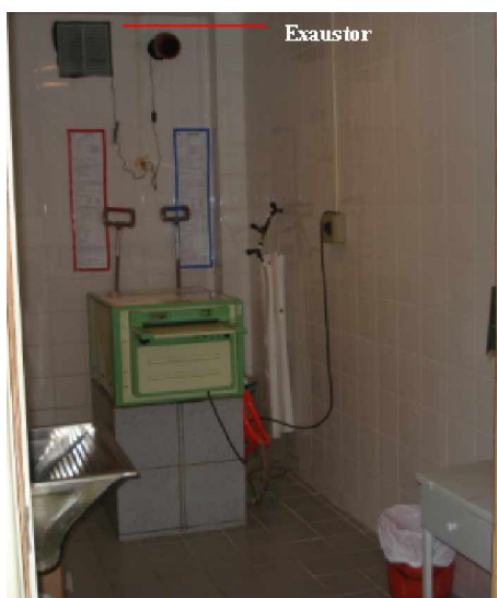
Figura 4.6. Localização do exaustor na câmara escura do hospital A.
